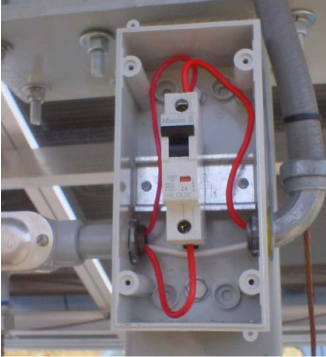
Fig. 5. Array disconnect using Moeller FAZ C6 DC
