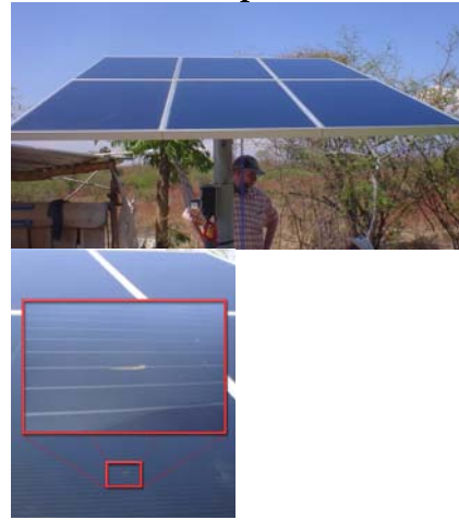
Fig. 6 Arreglo FV en El Laurel y rasgaduras en la película de la celda del módulo FV.
